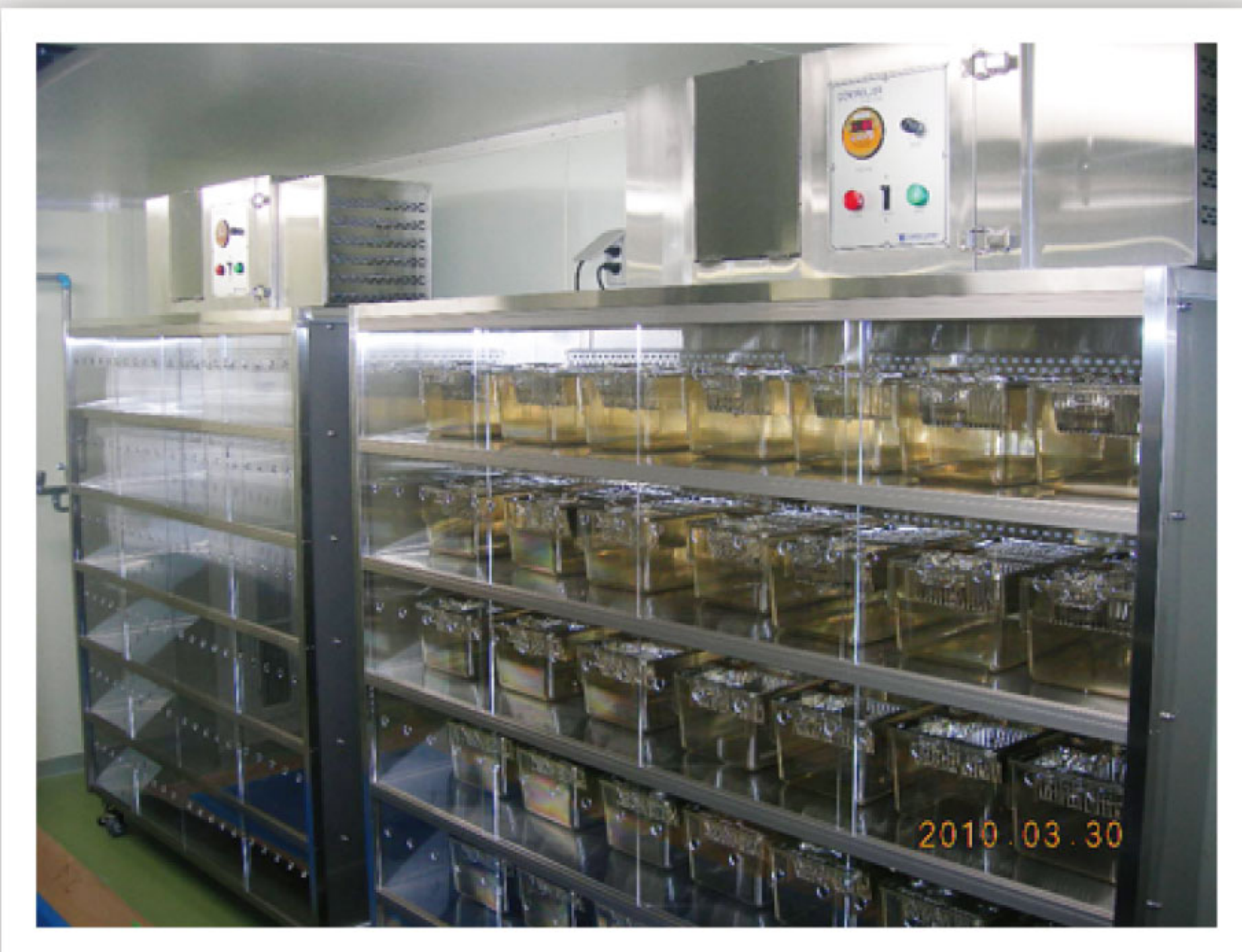
당사 제품 설치 전경
